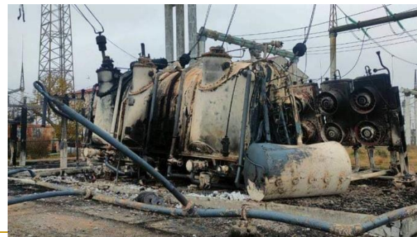
Знищений енергобєкт на Херсонщині
